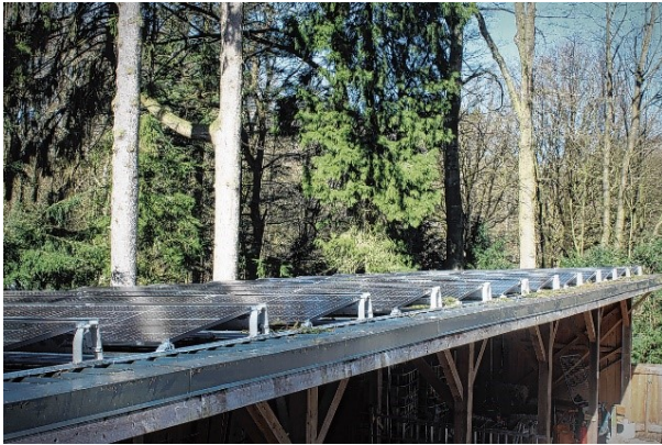
Die Photovoltaikanlage auf dem Dach eines Betriebsgebäudes der Försterei
